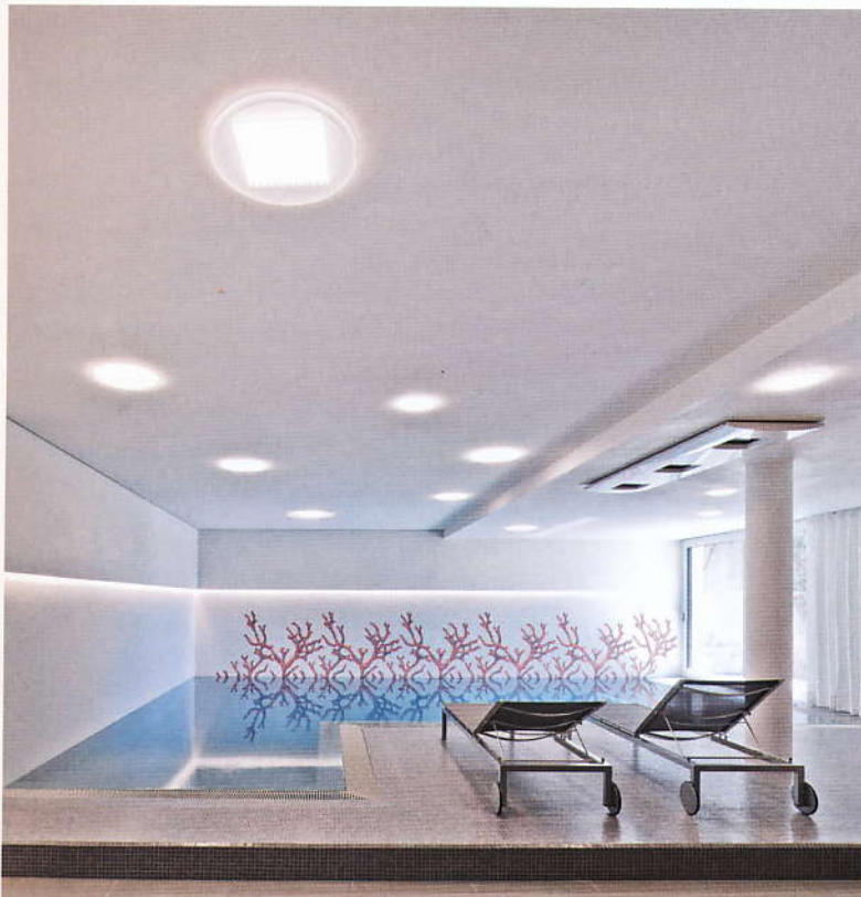
Im Schwimmbad kam ein LED-Lichtband zum Einsatz. | In the swimming pool area, an LED strip was installed.
